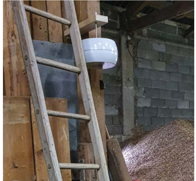
Bereits sechs Monate nach Montage des AQUAPOL® Geräts verbesserte sich die Feuchtesituation deutlich.
