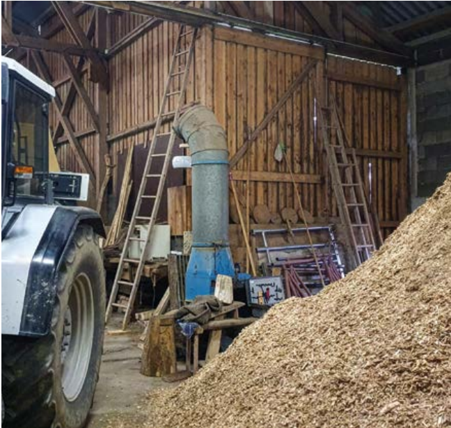
Stallgebäude zur Lagerung von Hackschnitzel und Heu mit Holzverschlag und dünner undichter Betondecke.
