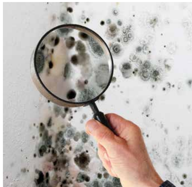
Abbildung 07: Schimmel am Mauerwerk
