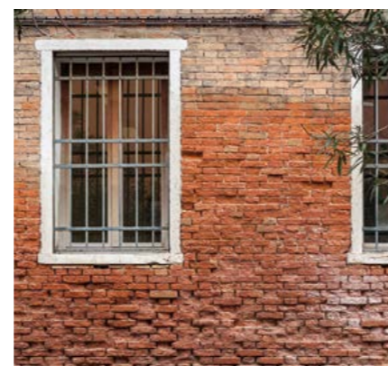
FOTO 02: Trotz Putzabschlagens blieb die Mauer teilweise sogar sichtbar feucht.
