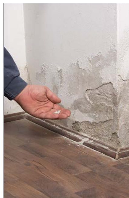
FOTO 01: Mauerwerksdiagnostiker helfen den Zustand der Mauer zu analysieren und beraten Sie zu den erforderlichen Schritten.
