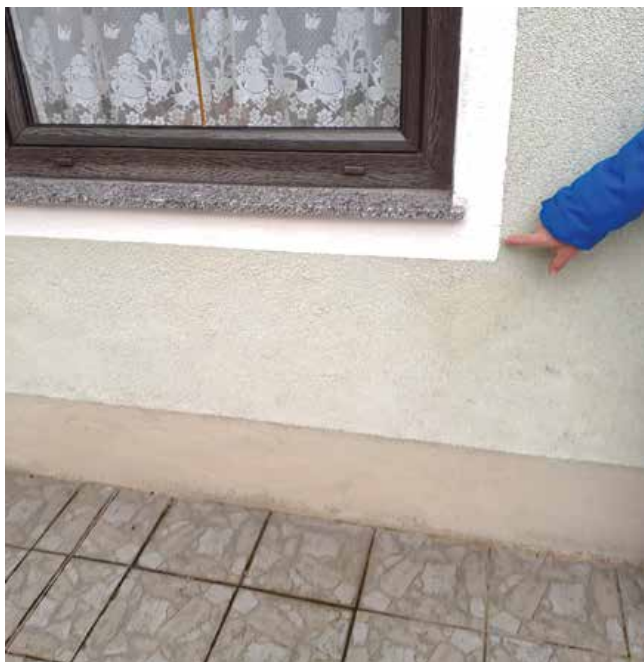
Die ehemalige Schadensgrenze der aufsteigenden Feuchte reichte bis zur Fensterbank.
