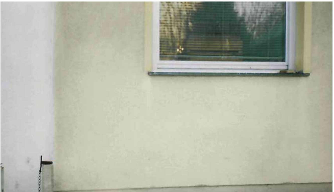
| volle Abtrocknung des noch nicht stark versalzenen Putzes – die Feuchtflecken sind verschwunden
