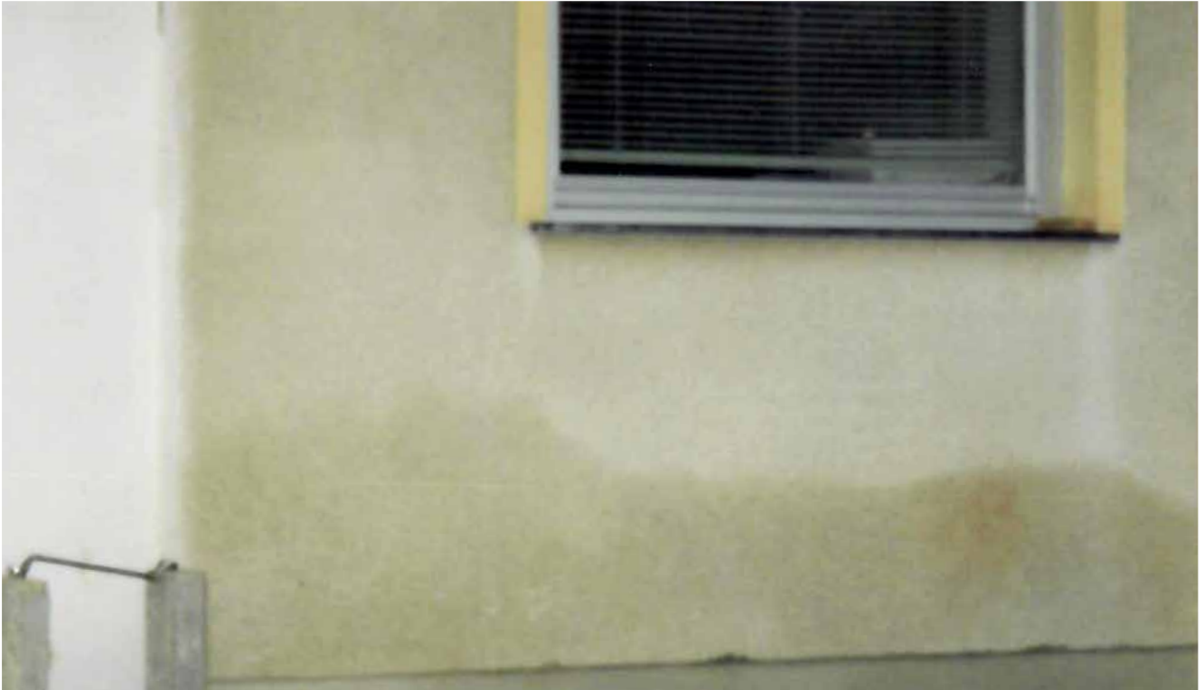
| hinterer Fassadenputz mit gut sichtbaren Feuchtflecken (2004)
