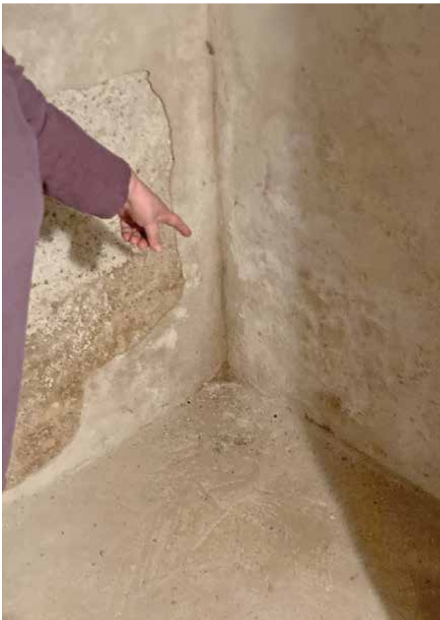
Eva Bauer zeigt auf die komplett aufgehellte Wand, die dank AQUAPOL® austrocknen konnte.
