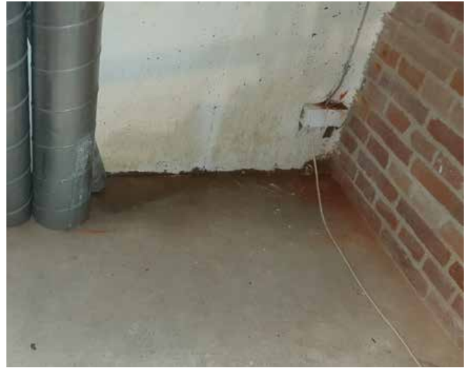
Weitgehende Austrocknung des Kellerbodens - keine Wasserlackenbildung nach Niederschlägen mehr sichtbar.
