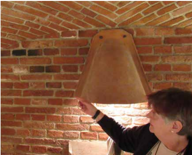
Weißer Schimmel hatte sich an den Wänden des Kellergewölbes gebildet.
