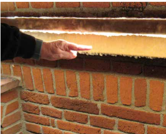
Unterhalb einer Holzlatte hing ein etwa 5 cm dickes Schimmelband.
