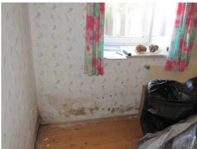
Die Schäden der aufsteigenden Mauerfeuchte waren auch in der Stube und im Wohnzimmer deutlich sichtbar.
