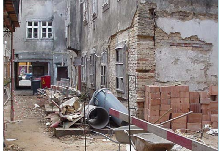
Das Gebäude vor der Trockenlegung durch AQUAPOL und der darauffolgenden Sanierung.
